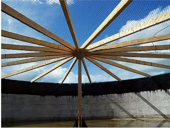
अंजीर. 14. व्यावसायिक बायोगॅस प्लांट (MT-ENERGIE GmbH & Co. KG) मध्ये डायजेस्टरच्या गॅस धारकास समर्थन देणारी लाकडी रचना आणि जाळी नेटवर्क
