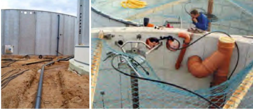
(a) MT-ENERGIE GmbH & Co. KG (b) BIOGAS NORD GmbH
